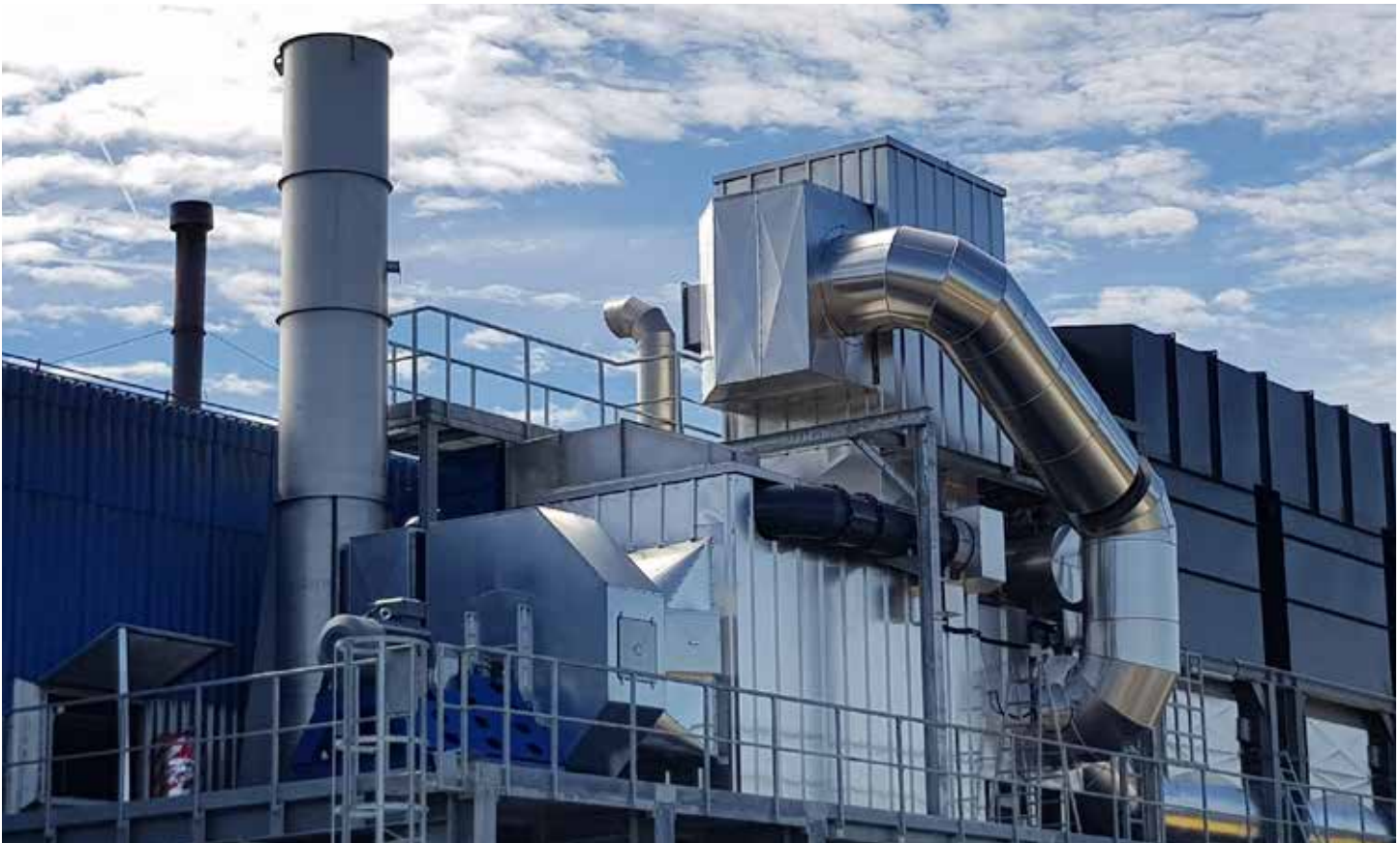
Postcombustión térmica regenerativa para la limpieza de gases de escape con disolventes con recuperación de calor integrada para aire caliente y vapor.
