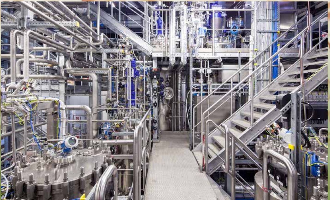
La planta de demostración de Leuna, cerca de Leipzig, Alemania, está equipada con las tecnologías más avanzadas para desarrollar el proceso de producción de isobuteno antes de implementarlo en una planta de escala comercial.
